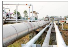
Pipeline 管道天然气
